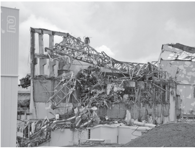
水素爆発後の福島第一原発3号機原子炉建屋の外観 (2011年3月15日 撮影:東京電力)
