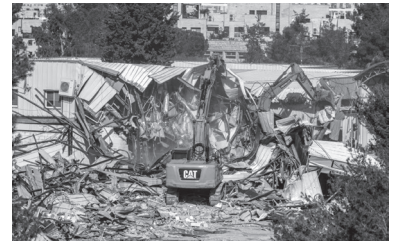
イスラエル当局によって破壊される UNRWA 本部の建物 = 1 月 20 日
